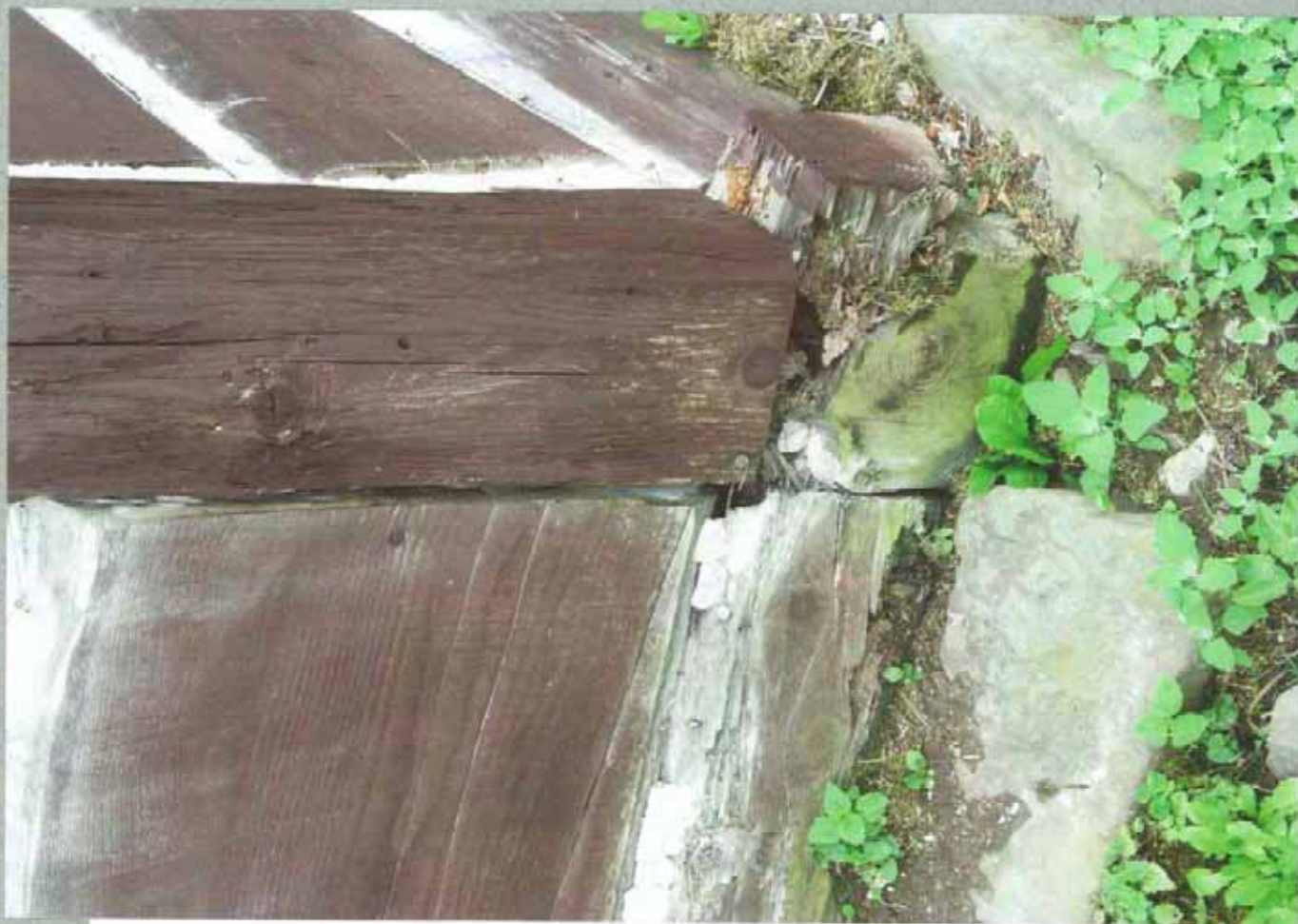
7. ZMURZAŁY ELEMENT ZAMKU PODWALINY OD STRONY PN-ZACHODNIEJ.
