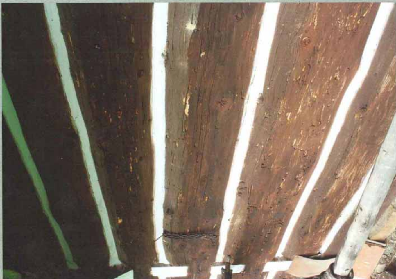
5. ZEWNĘTRZNA ŚCIANA ZACHODNIA. ZNISZCZENIA DREWNA SPOWODOWANE ŻEROWANIEM SPUSZCZELA.
